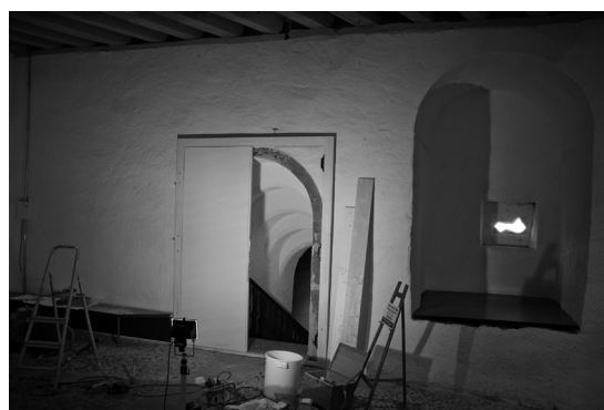
Nouvelle porte anti-feu au haut de l'escalier de la salle des Oron
