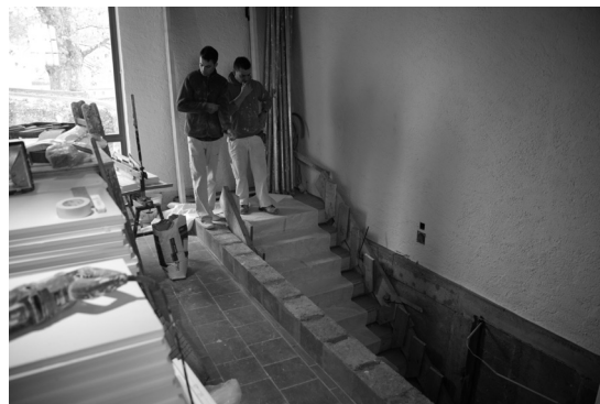
Préparation de la fondation de la paroi de séparation entre la salle et l'escalier
