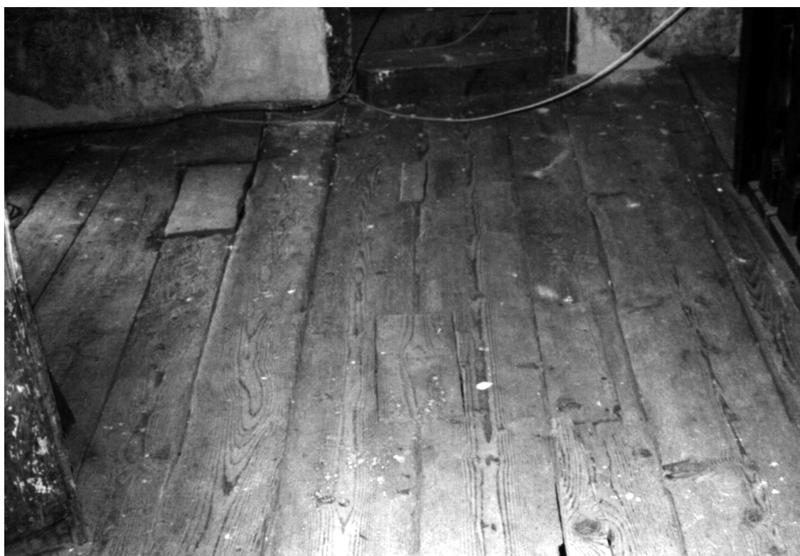
Le plancher de la galerie, très abîmé, avant la restauration.
